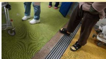
滑りやすい2棟浴室の危険箇所！
